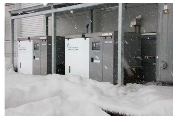
製造工場 SMS15SD(旧型機)×2台
